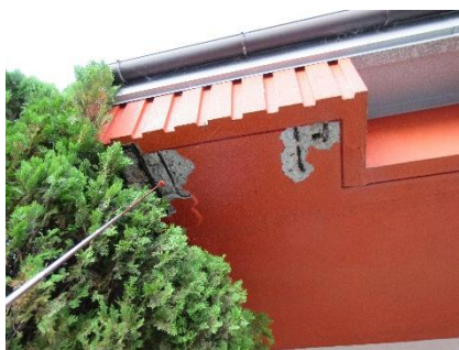
軒天の爆裂・露筋
