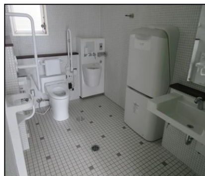
多機能トイレの設置
